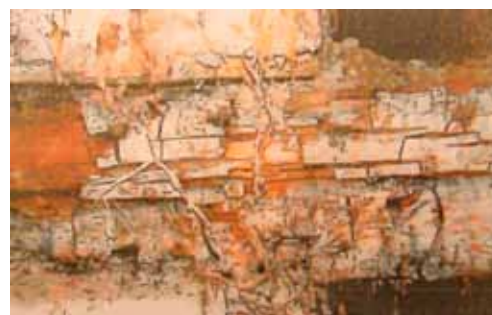
5. Trænedbrydende svampe angriber træ når fugtigheden er over 20%.
