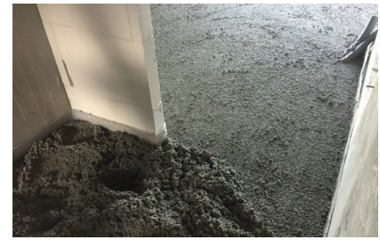
Figur 3. Ensartet EPS-beton med cementbindemiddel uden synligt hvidt EPS-tilslag.
