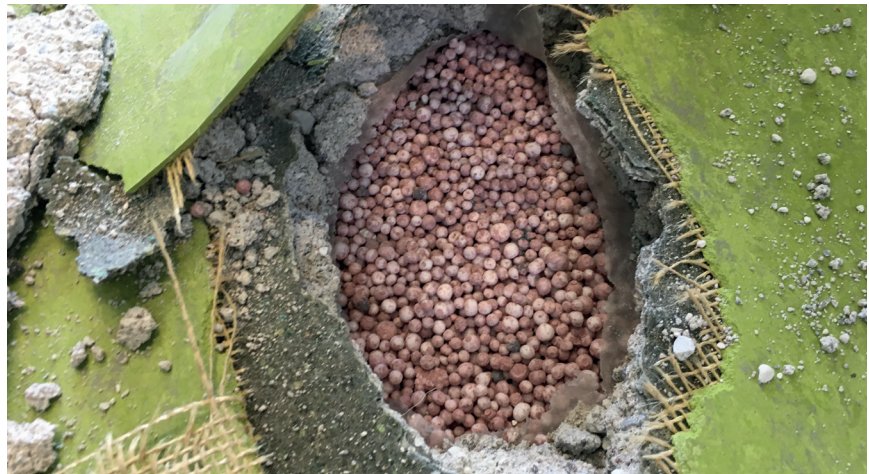
I Nedbrudt gulv med løst EPS-tilslag (EPS-kugler).
