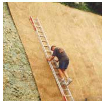
GREENFIX Rockmat typ 5D installeret i en skrån timer med en 65 graders hældning.
